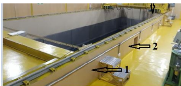
Gambar 3. Posisi retak pada dinding kolam yang diperiksa
