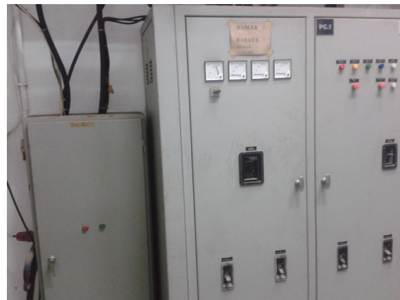
Gambar 3. Boks panel utama integrasi Untai Uji BETA dengan Uji HeaTiNG-01.
