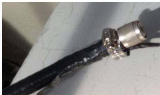
b. Socket -kabel hasil perbaikan dengan shielding ganda.
