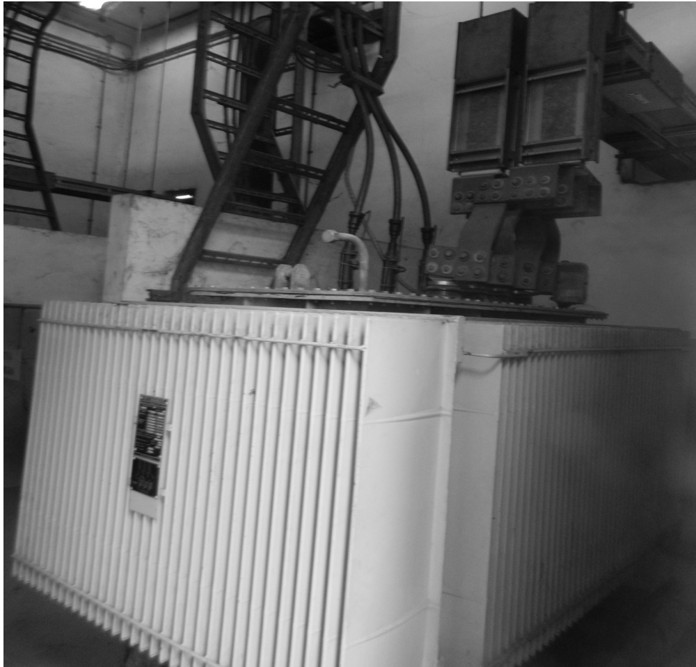
Gambar 1. Transformator MES gedung 71 yang diuji.
