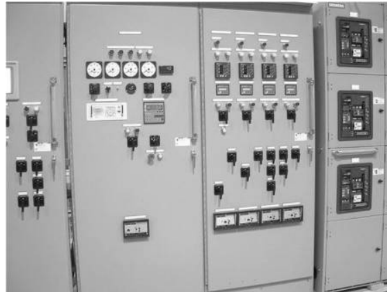
Gambar 1. Perangkat Hubung-Bagi (PHB) jenis konstruksi lemari [2] .
