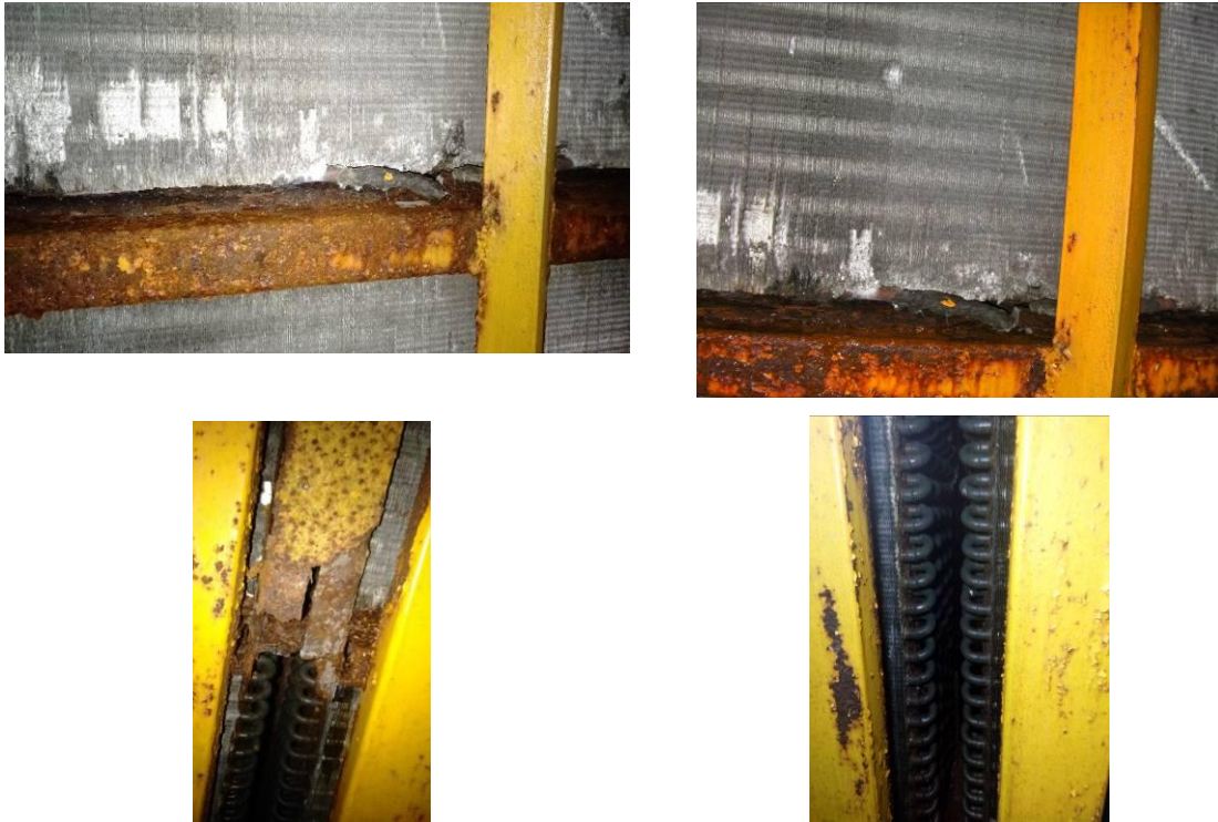
Gambar 10. Hasil pengamatan secara langsung di lokasi ruang cooling coil .
