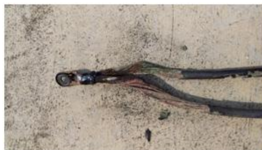
Gambar 8 : Kabel pada power Chiller 2B yang teridikasi penuaan
