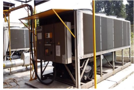
Gambar -1. Chiller yang terpasang
