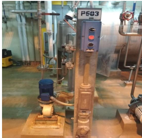
Gambar 6. Pompa Transfer UN P-603
