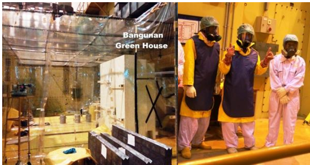
Gambar 2: Green house yang dibangun di sisi belakang hotcell ZG-102 dan ZG-103 (kiri) dan perlengkapan pelindung personil terhadap kontaminasi (kanan).
