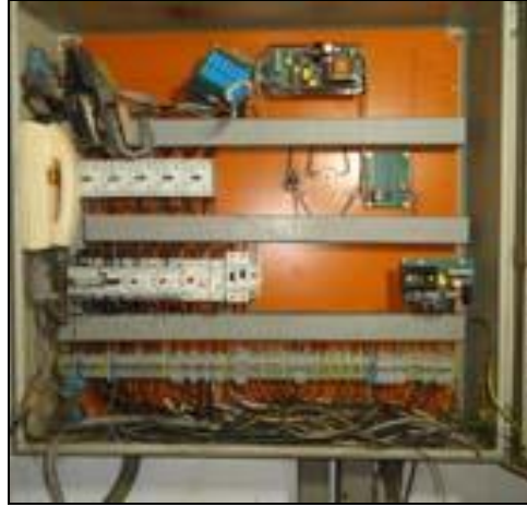
Gambar 3. Kontrol Panel sebelum perbaikan
