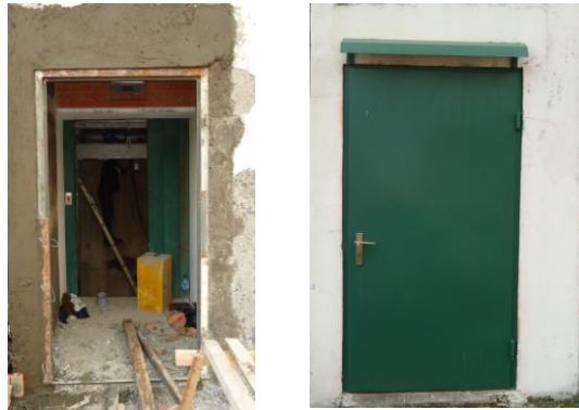
Gambar 5. Pintu tambahan lift
