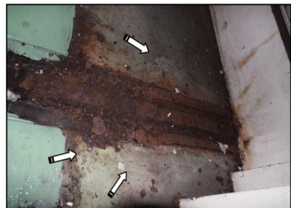
Gambar 4. Kerusakan rel wall plug dan bercak bekas genangan air (tanda panah)
