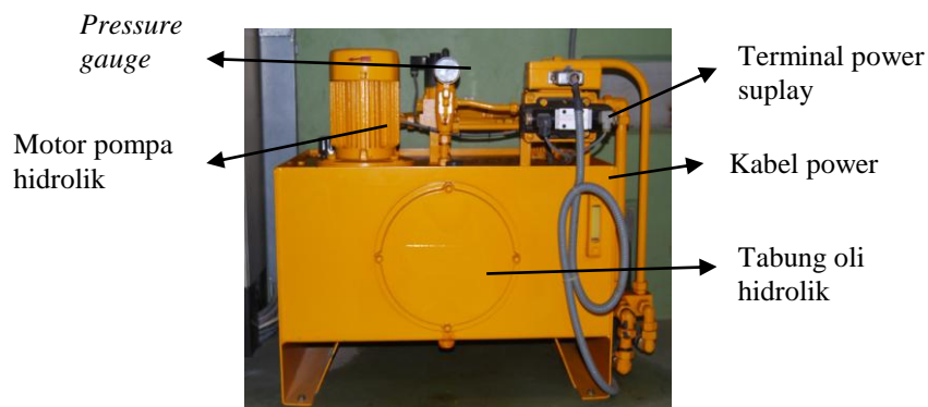
Gambar 5. Pompa hidrolik di ruang 005 basement .
