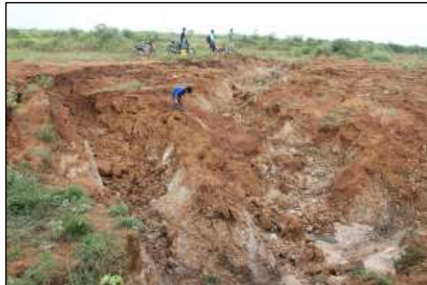
Gambar 4. Longsor pada Badan Jalan Desa di Kecamatan Gunung Sindur.
