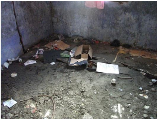
Gambar 12. Likuifaksi mengakibatkan kerusakan rumah penduduk di Kampung Bugis, Desa Labuan Mapin.
