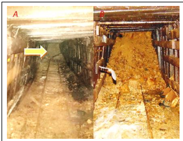
Gambar 5. Longsor di dalam TEURK pada tahun 2019 (A) dan 2015 (B)
