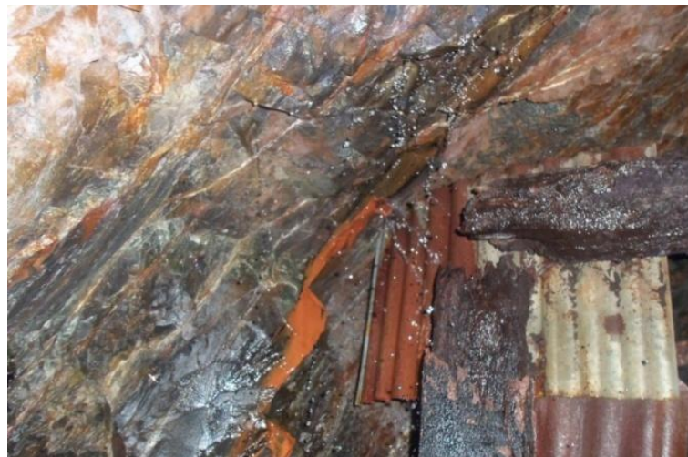
Gambar 7. Aliran airtanah pada rekahan di LP1.
