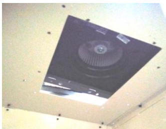
Gambar 5. Exhaust Fan Mesin
