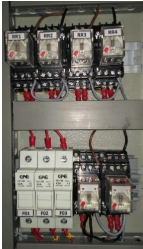
Gambar 9. Relay tambahan untuk kendali jarak jauh sistem pendingin primer.
