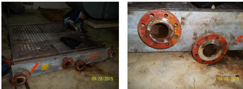
Gambar 2b. Kerusakan pada pipa-pipa coil pendingin
