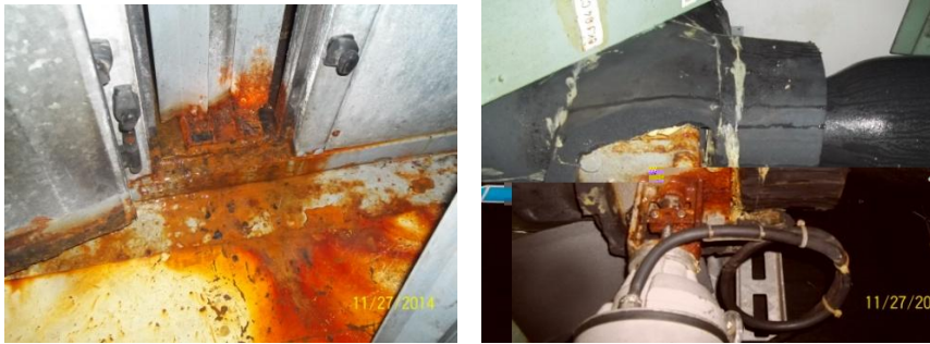
Gambar 2a. Bagian kebocoran pada casing AHU dan kerusakan pipa distribusi
