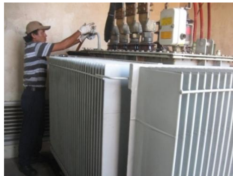
Gambar 2. Perawatan trafo RSG-GAS
