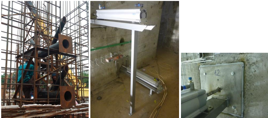
Gambar 5. Persiapan lubang silinder pneumatik saat konstruksi sipil (kiri), penyangga silinder pneumatik setelah terpasang (tengah) dan as piston C12 menembus beton labirin
