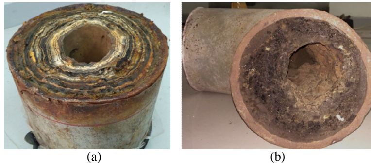
Gambar 1. Sampel pipa dengan scale , (a) pipa PLTP, (b) pipa furnace .
